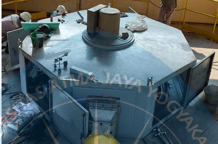
Gambar 1.2. Pintu Inspeksi Generator LGS#3
