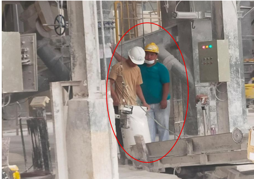
Gambar 1.4. Pekerja Tidak Menggunakan APD (Masker, Sarung Tangan)
