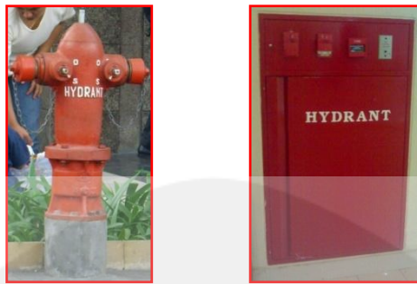
Gambar 6.12 Peralatan Pemadam Kebakaran
