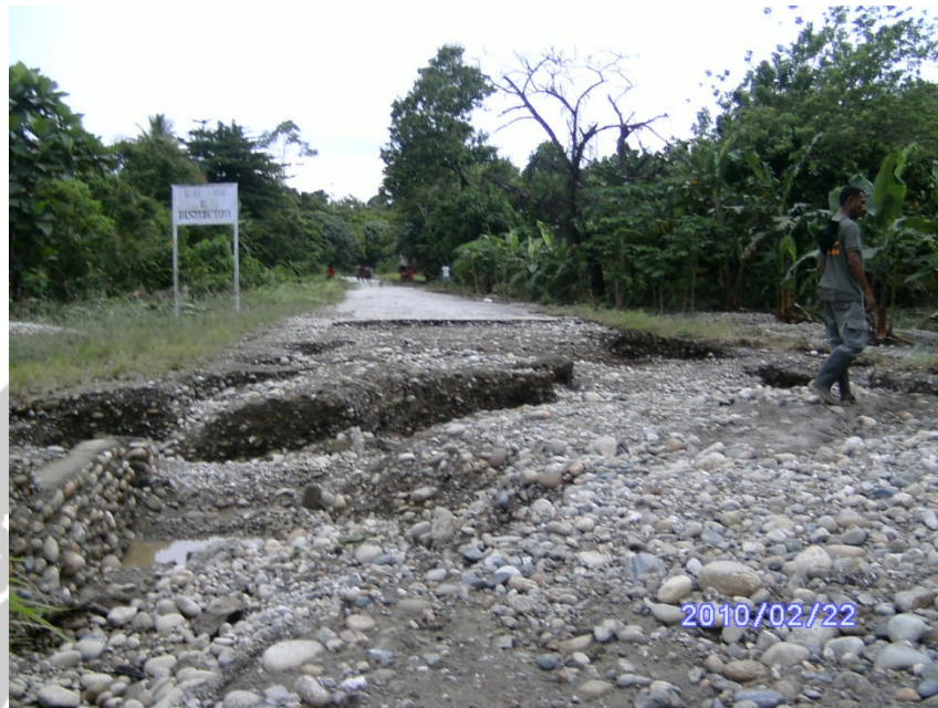
Foto 31: badan jalan yang rusak akibat banjir
