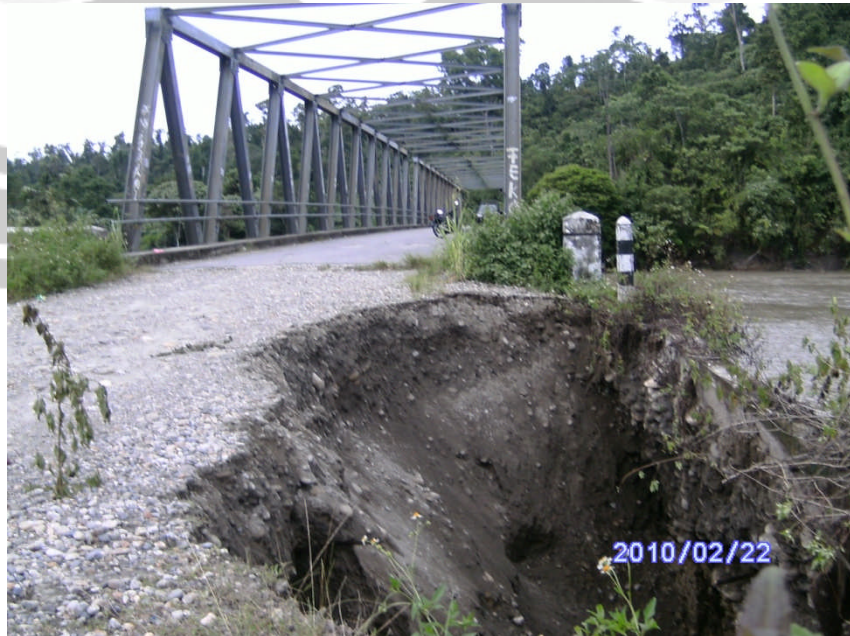
Foto 30: badan jalan yang rusak akibat banjir
