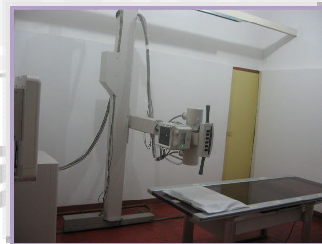
Gambar. 2.11. Ruang foto unit radiologi
