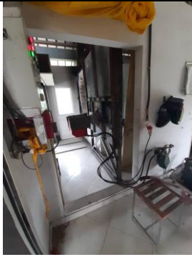
Gambar. Ruang Pengontrolan Tungku
