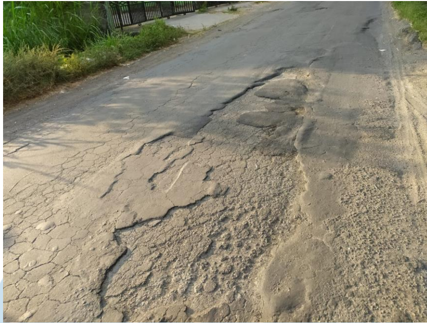
Gambar 1.3 Kondisi perkerasan Jalan LPM
