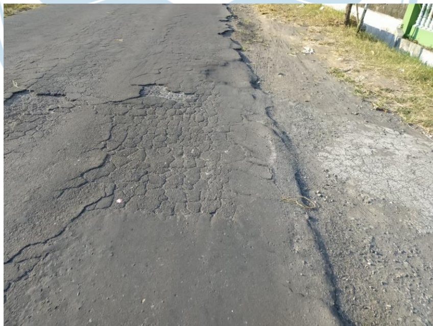
Gambar 1.2. Kondisi perkerasan Jalan LPMP
